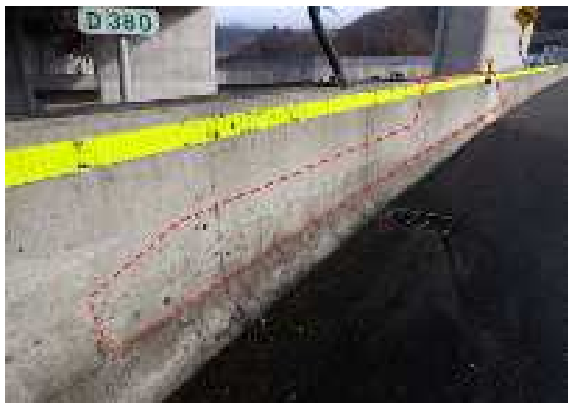
【コンクリートのひび割れ、浮き】
