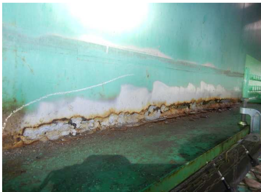
鋼橋桁損傷状況
