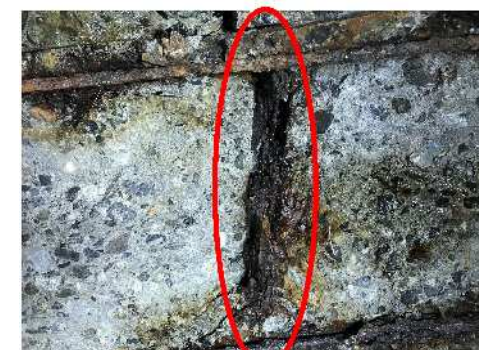
【PC横締ケーブルの破断】
