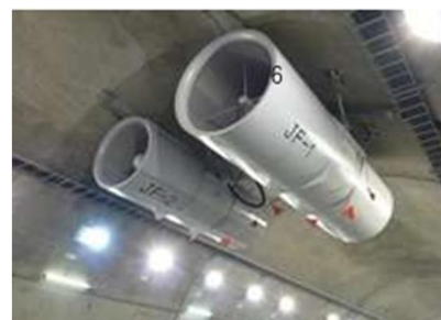
換気設備(ジェットファン)
