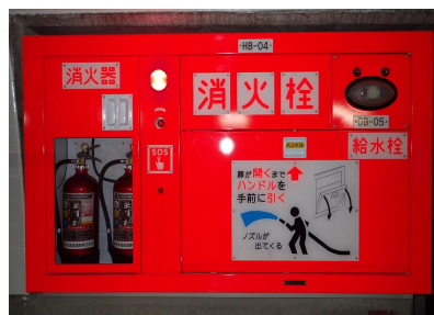
非常用設備(消火栓)
