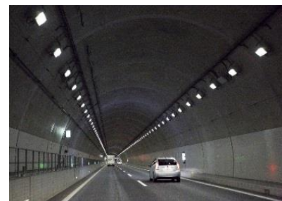
トンネル照明
