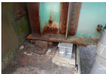
(判定区分Ⅲ 補修前)
