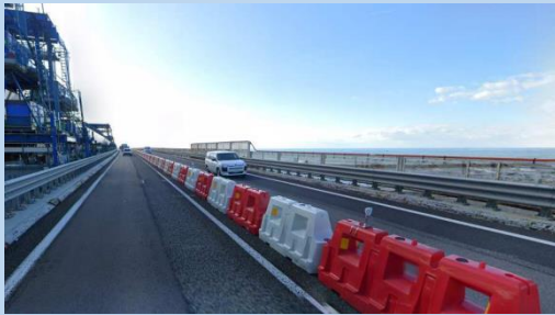
(現場で設置されているポリエチレン製の防護柵)
