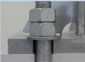
(腐食の発生が懸念される部分)
