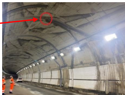
(トンネル打継目から漏水)
