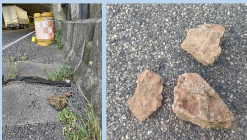
(落石があった現地の状況)
