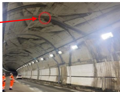
(トンネル打継目から漏水)
