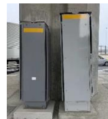
(扉が変形している制御盤(右側))
