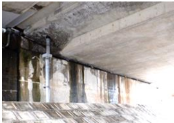
（判定区分Ⅲ：桁端部塩害劣化の補修前）
