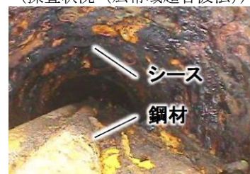
(PC 鋼材の腐食状況)
