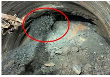
(高松トンネル 断層破碎帯区間における脆弱な切羽の状況)
