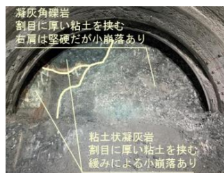
(トンネルの切羽崩落状況)
