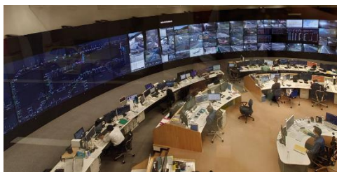
(道路管制センターでの常時監視)
