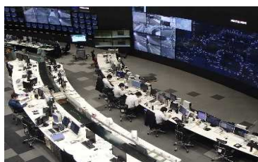
(道路管制センターでの監視)
