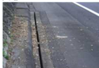
(路肩に散乱した砂利)
