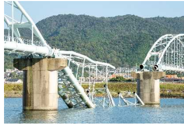
（国交省/崩落した水管橋）
