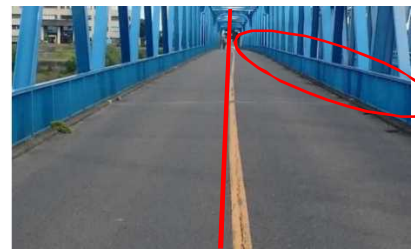
(川島大橋 橋面のゆがみ /岐阜県 HP)
