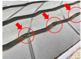
(ゴム製伸縮装置の表面の腐食)
