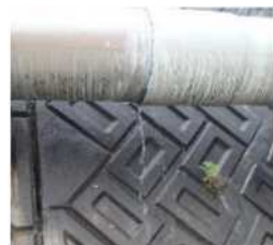
(のり面からの漏水箇所)
