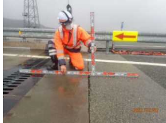
（橋梁ジョイント部の段差）
