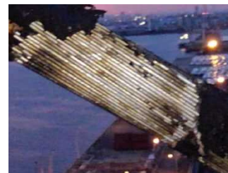
(熱せられた斜材ケーブル)
