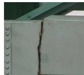
（ARDOT / 破断した鋼材（2020年））
