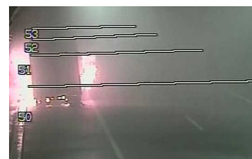
(トンネル内の水噴霧装置の稼動)
