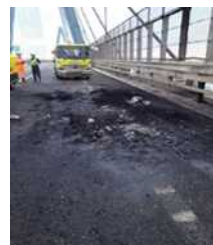
(車両火災の発生現場)
