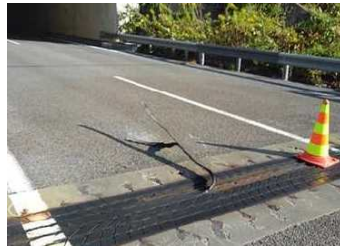
(損傷したゴム製伸縮装置)
