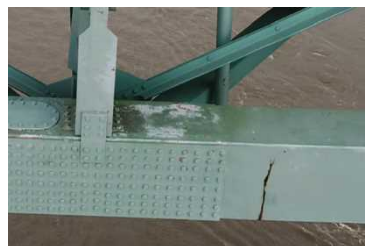
（ARDOT / 損傷した鋼材（2019年））
