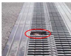
(鋼製フィンガージョイントの疲労損傷)
