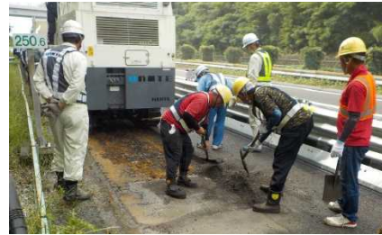
(鋼製仮設防護柵)
