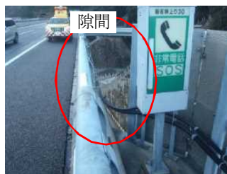
（転落防止柵と防護柵との隙間）
