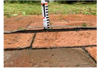
(蓋の枠の浮き上がり)
