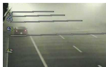
(トンネル内の水噴霧装置の稼働)
