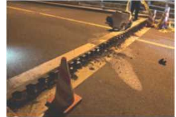
(山口県/ジョイント部の浮き上がり)
