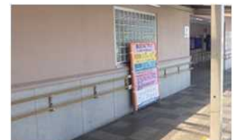
(手すりを塞いでいた看板)
