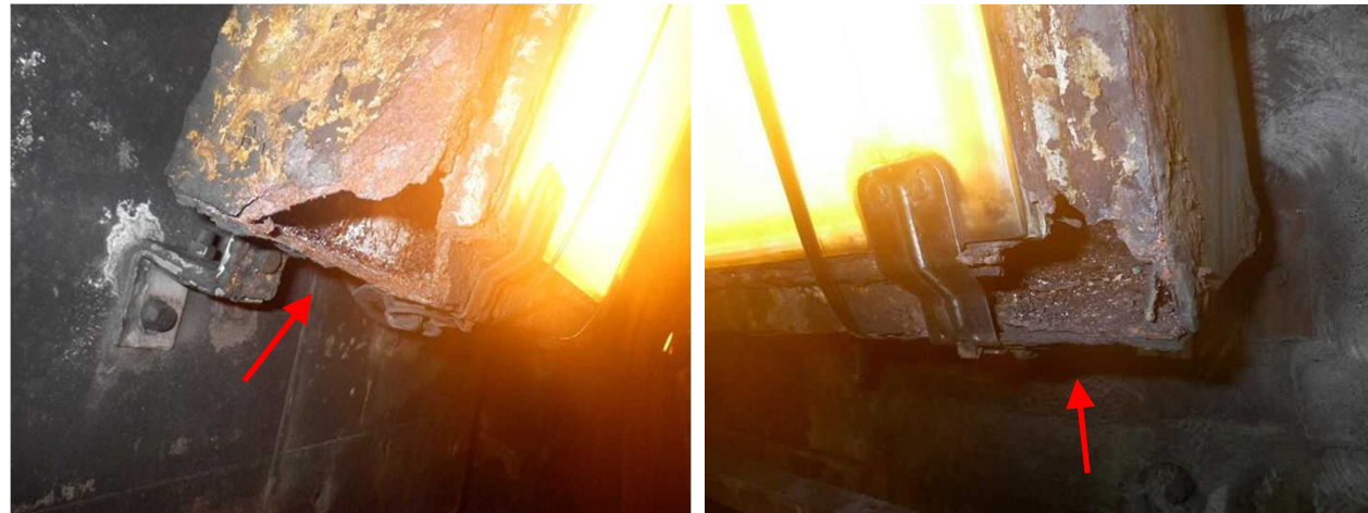
図3-1 緊急点検で撤去した灯具の変状① (灯具本体の角部に穴あきがある状況)
