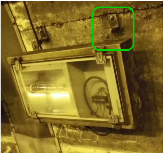
図２－１ 宇利トンネル照明灯具の設置状況
