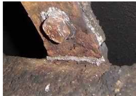
図7-3 平成25年1月の点検写真 (落下灯具 L-184)
