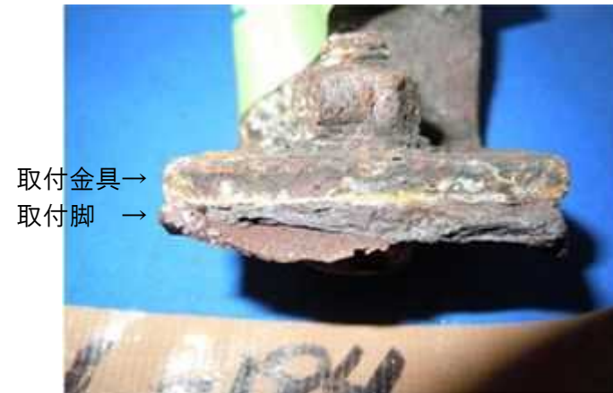
図 6-1-4 取付金具側の取付脚破断面（右上）
