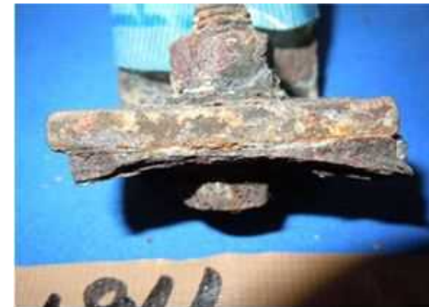
図 6-1-5 取付金具側の取付脚破断面（左上）
