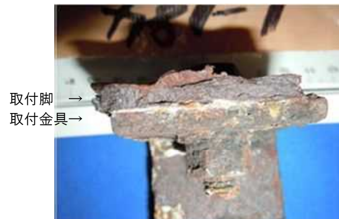
図 6-1-7 取付金具側の取付脚破断面（右下）
