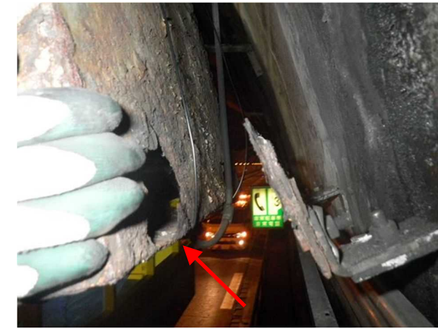
図3-2 緊急点検で撤去した灯具の変状② (取付脚周辺の灯具本体に穴が開いた状況)
