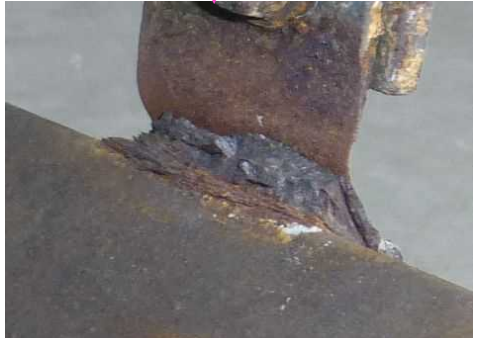
図7-5 (参考) 平成27年8月に撤去した照明灯具 (R-2) ※落下した灯具と同様に扇形状に開口
