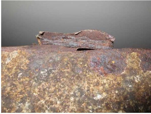
図7-4 平成27年8月の状況写真 (落下灯具 L-184) ※灯具本体と取付脚の合わせ部が扇形状に開口
