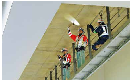
2014年 橋梁等の道路構造物に関わる省令点検の義務化
