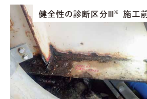
※ 構造物の機能に支障が生じる可能性があり、早期に措置を講ずべき状態
