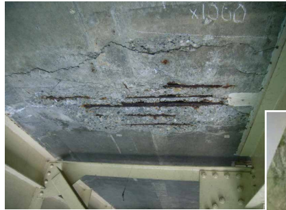
コンクリートのはがれ落ち、浮き
