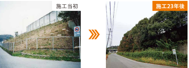
のり面の樹林化の状況
