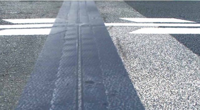
伸縮装置からの漏水対策
