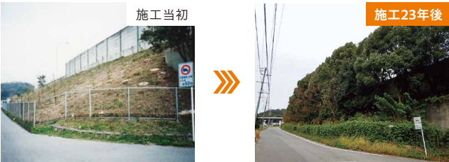
のり面の樹林化の状況
