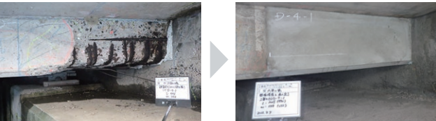
コンクリート橋桁端部の変状と補修状況
