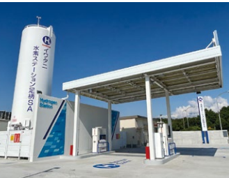
足柄SA(下り)水素ステーション
