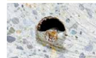
PC橋の鋼材の腐食を防止する材料の充填が不足
