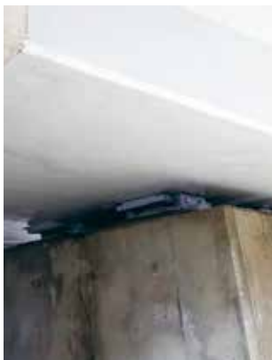
コンクリート片落下対策
