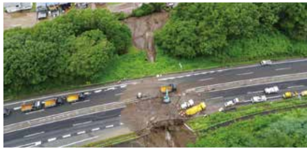
中央自動車道 岡谷JCT～伊北I.C.間で発生した土石流による被災状況（2021年8月15日）
