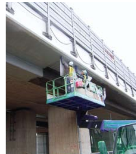
橋梁のはく落防止対策
