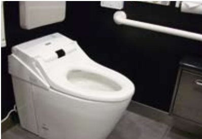
節水型便器（省エネルギー） お客さまトイレに節水型便器を使用。
