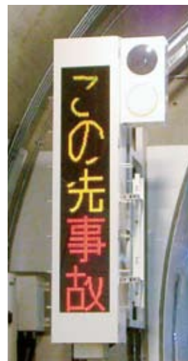
施設設備の損傷事例／ 情報板の表示部劣化
