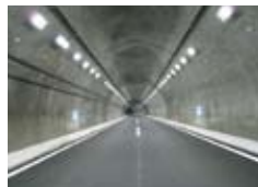
セラミックハイドランプの照明設備
