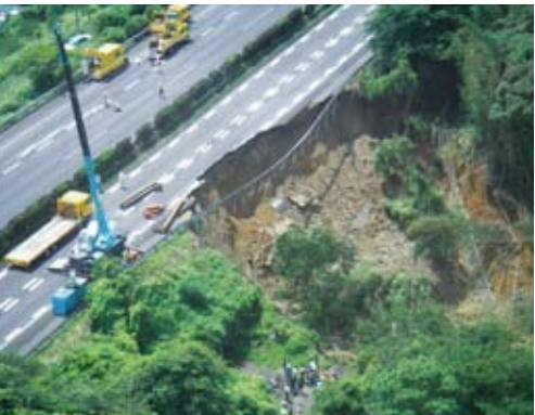
被災直後の状況
