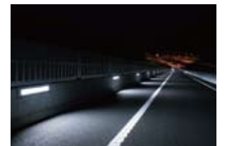
圏央道 八王子JCT 低位置照明設備
