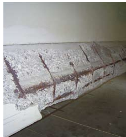
橋梁の損傷事例／飛来塩分による損傷
