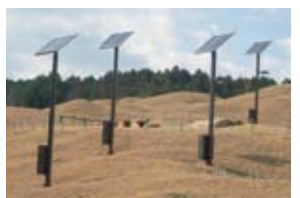
新東名 土山SAの太陽光発電照明
