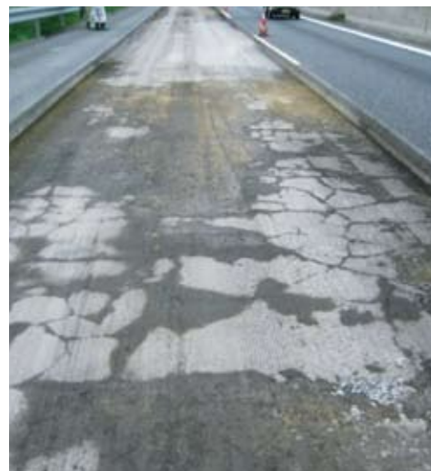
舗装の損傷事例／道路基層面のひび割れ
