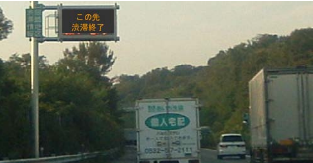
LED 情報板の設置
