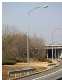
旧型の照明設備
