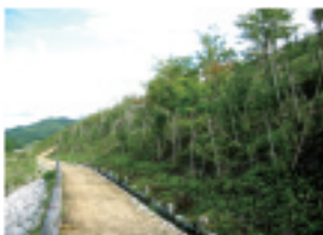
盛土のり面の樹林化
