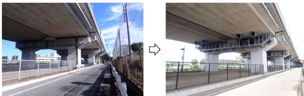
【橋脚の耐震補強および落橋防止装置の設置(E84 新湘南バイパス 西久保高架橋)】
