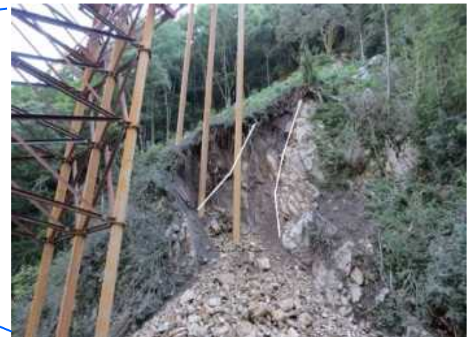
のり面の崩落
