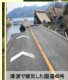
津波で被災した国道45号
