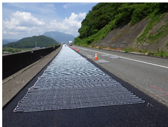
ロードヒーティング設置状況
