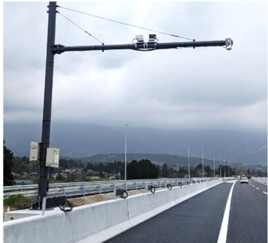
【通信用アンテナ】
