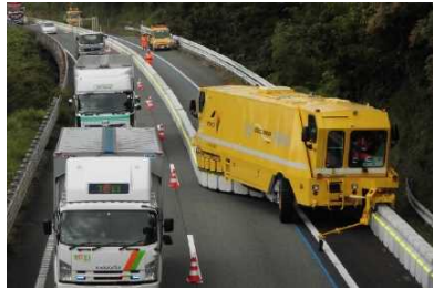
(コンクリート製仮設防護柵)
