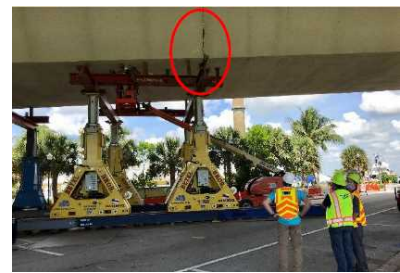
(FDOT HP/ルーズベルト橋の桁の亀裂)
