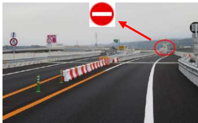
(分岐部から遠く見えにくい進入禁止の規制標識)
