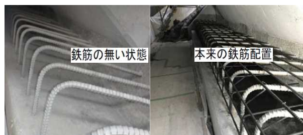
(橋台の鉄筋不足)
