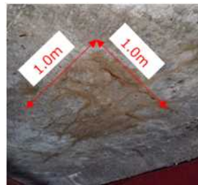
（橋梁の床版下面の変状）
