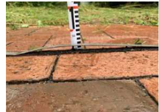
(蓋の枠の浮き上がり)
