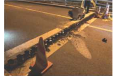
(山口県/ジョイント部の浮き上がり)
