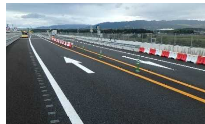
(路面標示で進行方向を明示)
