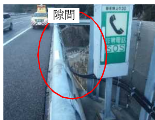
（転落防止柵と防護柵との隙間）
