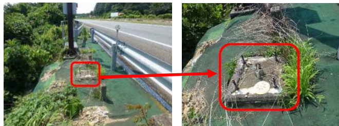
(道路附属設備の撤去後に残された基礎とアンカーボルト)
