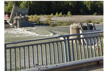
(Google/崩落したカプリリオラ橋)
