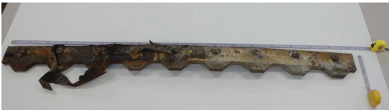
【破損した伸縮装置】
