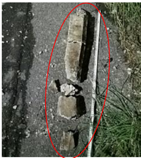
落下したコンクリート片 4片
