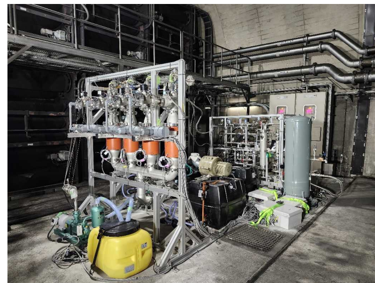
現地に設置したCO 2 回収装置
