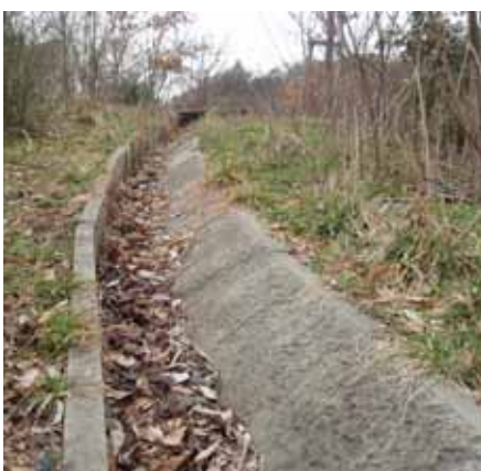
ビオトープ内の排水溝
