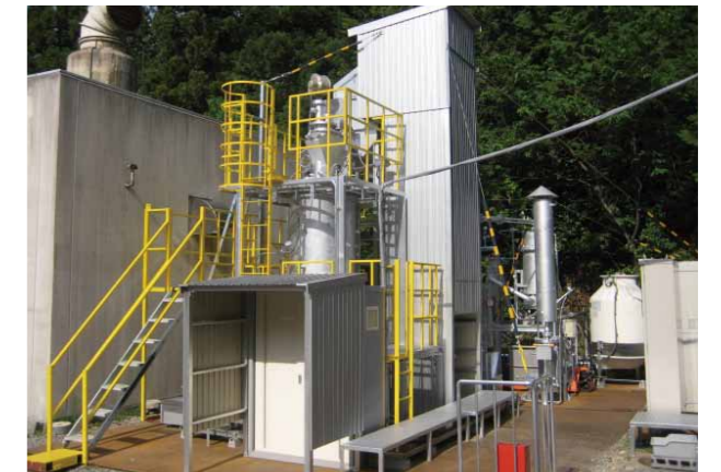
バイオマス試験用プラント(2011年試験完了 多賀SAに設置)
