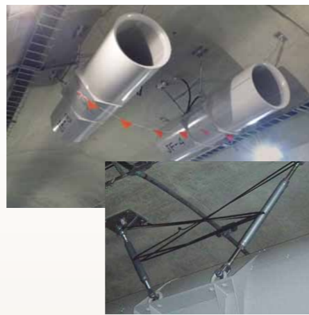
ジェットファン落下防止対策(紀勢道)(ワイヤーによる固定)
