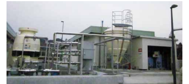
ペレットボイラー(新東名 藤枝岡部IC料金所)
