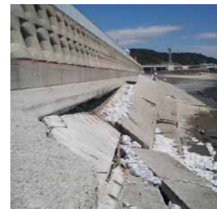
西湘PAの護岸の変状
