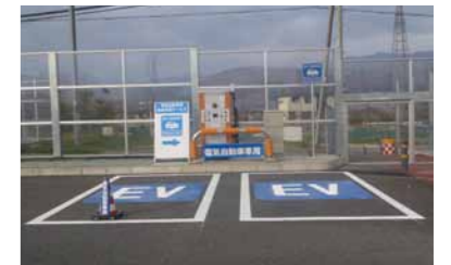
中央道 双葉SA(下り線)に整備したEV用急速充電器
