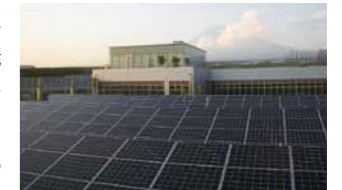
富士保全・サービスセンター屋上に設置した太陽光パネル
