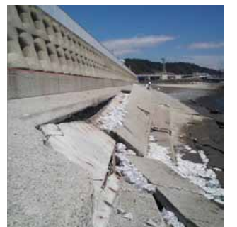
西湘PAの護岸の変状
