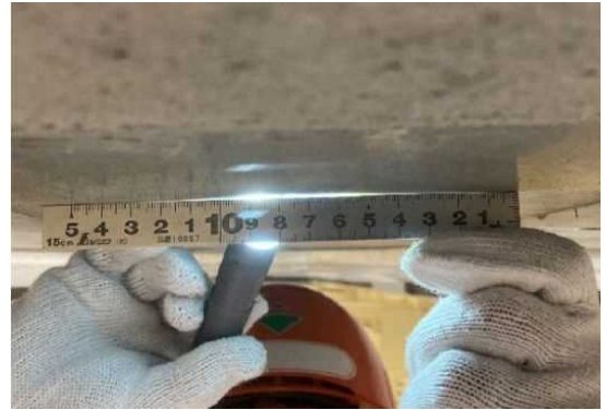
写真-4 縦目地部の上反り状況
