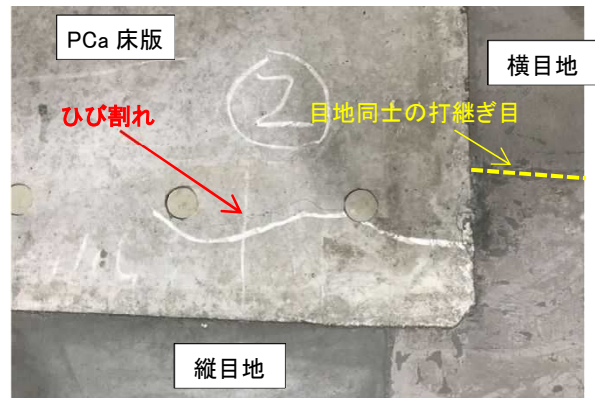
写真-2 ひび割れ発生状況②
