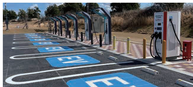
浜松SA(下り)に設置した150kW級の高出力急速充電器(写真右側)
